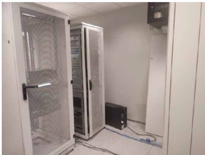
Zdjęcie nr 4: Widok ogólny na serwerownię.
